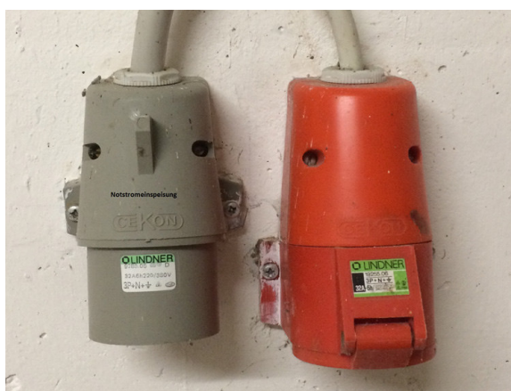
Abb. 13: Sichere Notstromspeisung in das Stromnetz eines Gebäudes. Foto: I. Brandmüller, LRA Altötting
