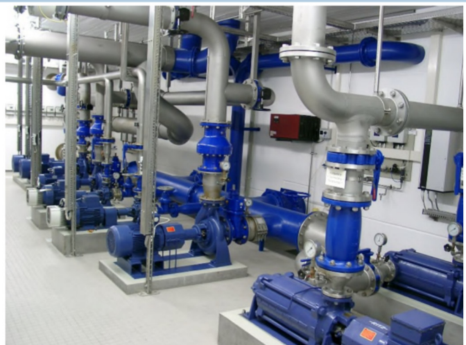
Abb. 3: Technische Ausrüstung in einem Pumpwerk (Symbolbild). Quelle: LfU.
