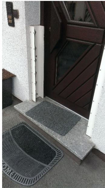
Abb. 3: Halterungen für Dammbalken an einem Hauseingang, Quelle: Christoph Oberacker.
