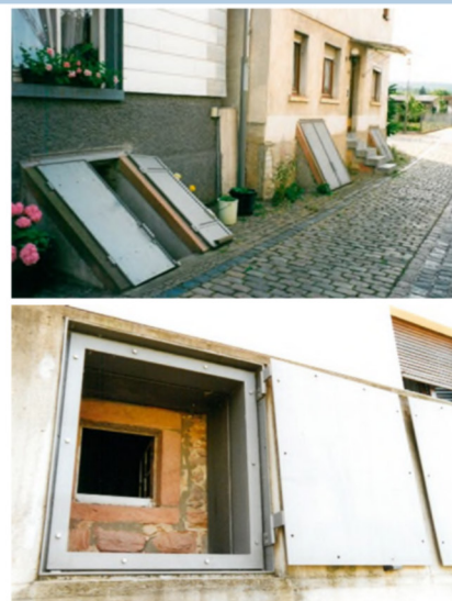
Abb. 2: Objektschutzmaßnahmen (oben: Abdichtung eines Kellerabgangs, unten: Abdichtung von Fenstern), die auch zu Demonstrationszwecken genutzt werden können. Quelle: LfU.
