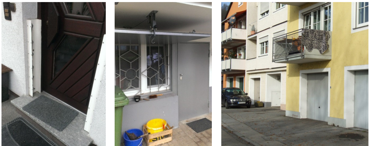
Abb. 6: Einfache Maßnahmen können große Schäden vermeiden: Halterung für ein mobiles Barriersystem (links), Fensterklappe (Mitte), hochwasserangepasstes Bauen in der Passauer Ilzstadt (rechts).
